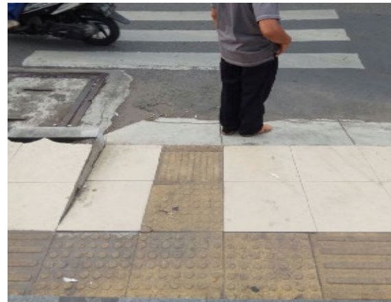
Gambar 20. Daerah sebelum penyeberangan yang tanpa dilengkapi ubin peringatan
