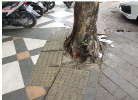
Gambar 23. Ubin yang permukaannya tidak rata
